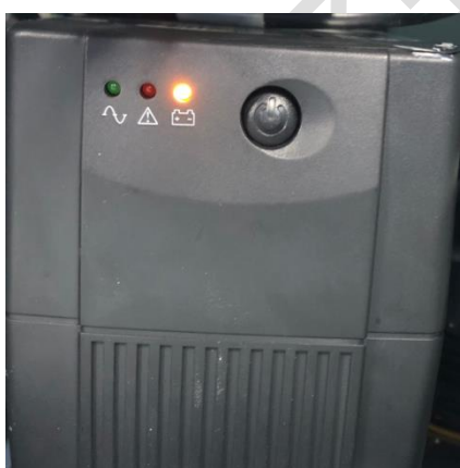
a)UPS 电源开关
